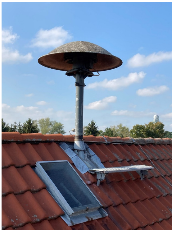
Motorsirene auf einem Dach in Ummendorf. (Foto Marcel Nienstedt / wird zur Veröffentlichung freigegeben)
